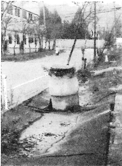
写真－３ マンホールの浮上
